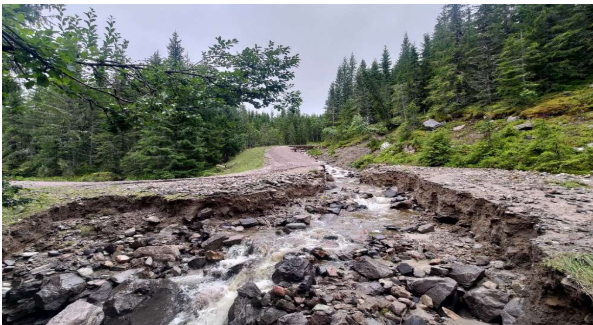
Store skader etter «Hans». Her fra Grunntjernsvegen.
